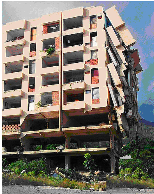
c. Construction partiellement détruite, Seca Venezuela 1999, [www.answers.com].
