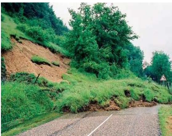
Glissement en Isère, France [4]
