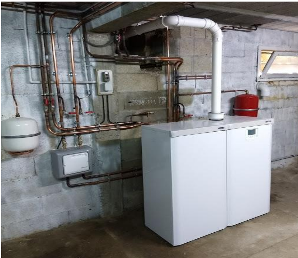
Fig. II.2 Chaudières au sol
