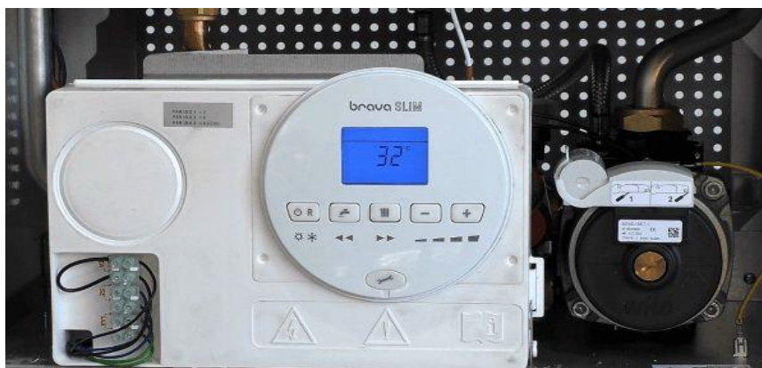
Fig. II.35 Panneau de commande de la chaudière
