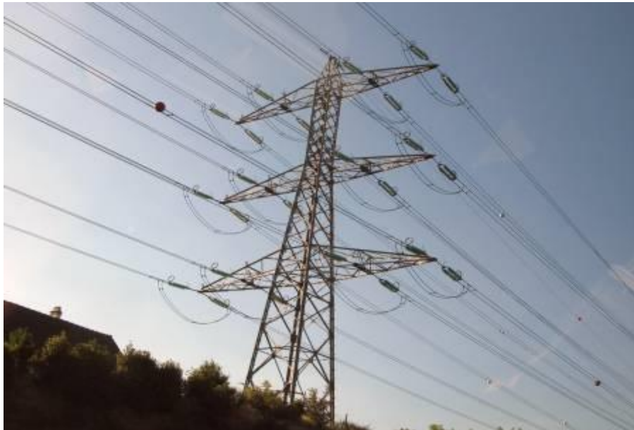
Fig. I-06 : Photo d'une ligne haute tension.
