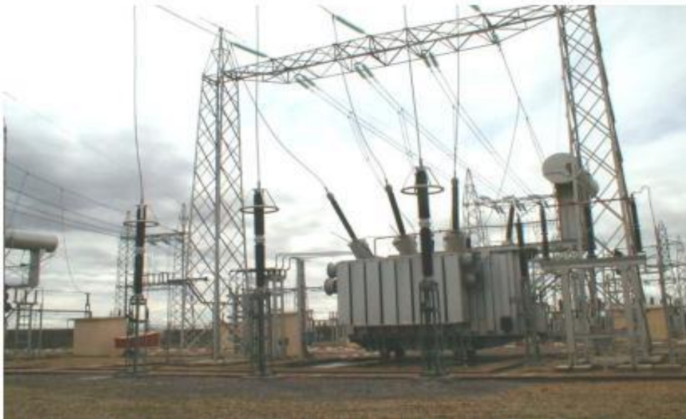
Fig. I-08 : Photo d'un parafoudre [4].
