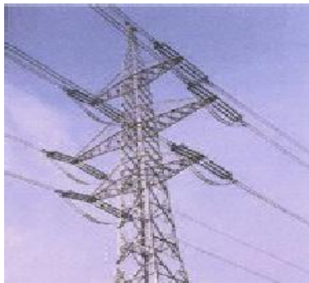
Figure.I.10. photo d'une ligne à très haute tension (double terne en faisceau). [7]
