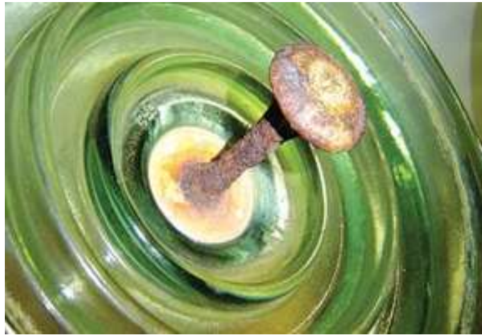
Figure III. 1. Dégradation d'un isolateur
