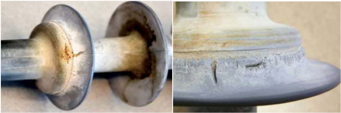
Figure II. 13. Dégradation des isolateurs composite
