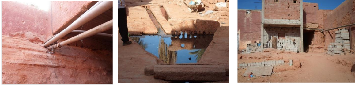
الصورة رقم (38): شبكة صرف المياه دلدي، 2015
