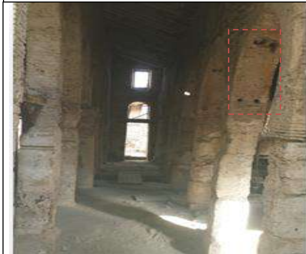
الصورة رقم (07): أثار استعمال الخشب
